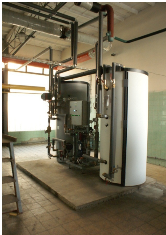
Ohrev teplej vody
