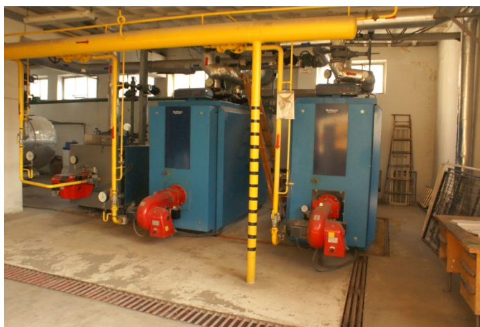
Tabuľka 8 Charakteristika kotlov inštalovaných v PK Stred
